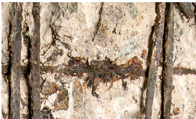
■ Betong vittrar sönder av armeringskorrosion.
